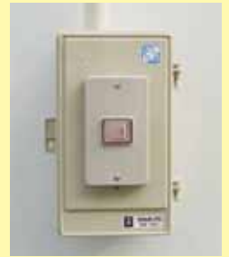
分電盤 防雨型照明スイッチ
