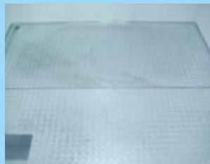
室内縞鋼板床
