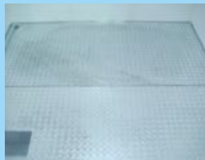
室内縞鋼板床
