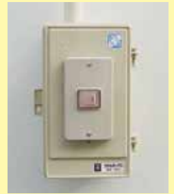
分電盤 防雨型照明スイッチ
